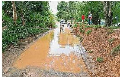
甘榜占布旁小路积水后，园主设法挖通排水口。（林海霞摄）
